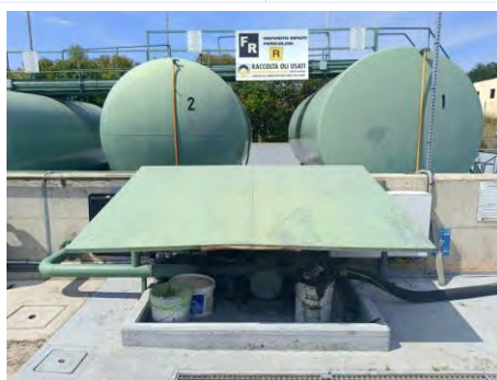
Fig. 3 –Serbatoi di stoccaggio e sistema di pompaggio. 5
